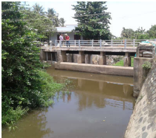
Hình 2.7: Đập Suối Ké hiện trạng trong khu vực dự án (hoạt động tốt)
