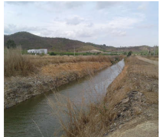
Hình 2.6: Tuyến ống chuyển nước Đu Đủ - Tân Lập đã thi công hoàn thành
